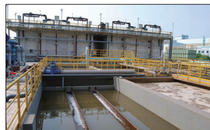
污水处理设备
